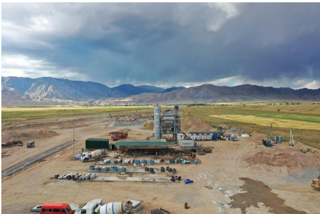
Рисунок 17: АБЗ на территории производственной площадки (км 148+630)
